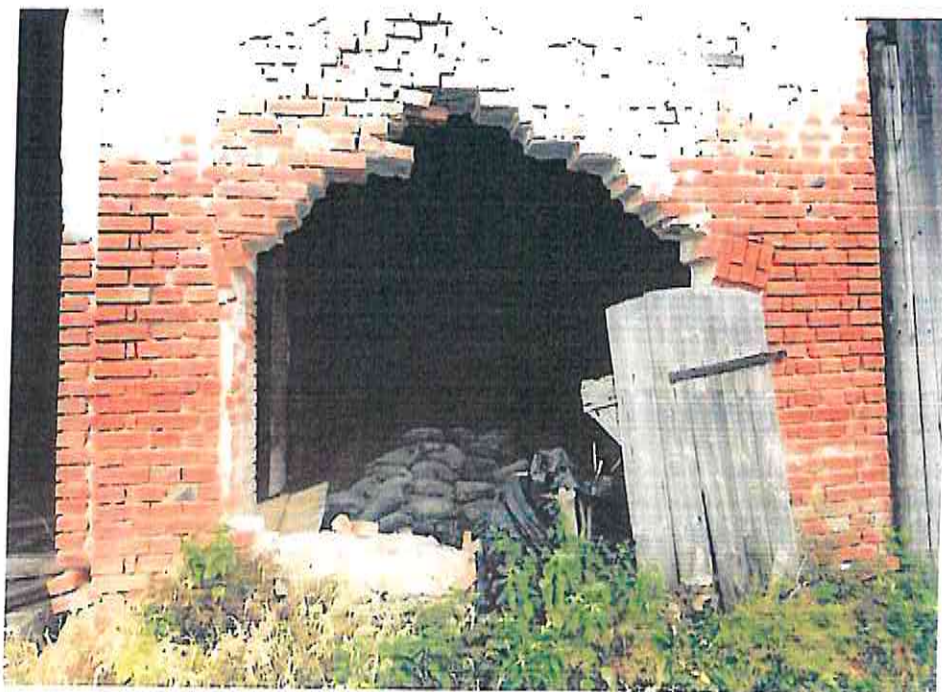
Dožilá vrata objektu
