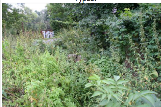
Náhon z obtokového kanálu je zanesený
