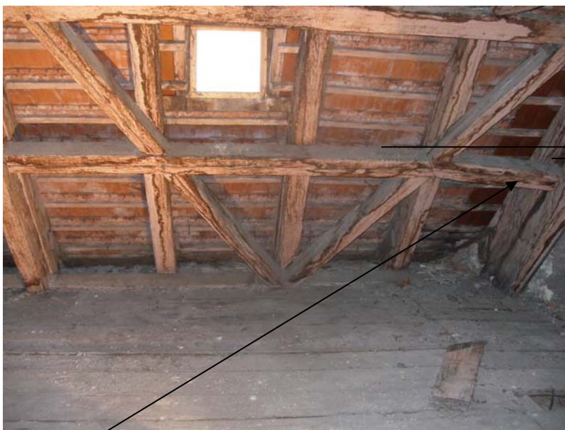
POKLES VZPĚRY VAZBY - PRAVDĚPODOBĚ UHNILÁ SPODNÍ ČÁST \ VZPĚRY
