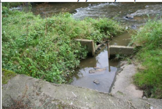
Výpust' a vývařístě s hrazením
