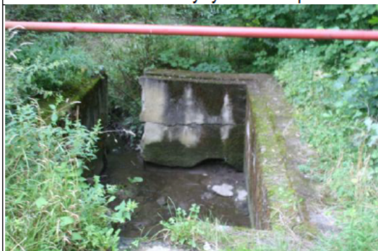
Objekty rybníka jsou v havarijním stavu
