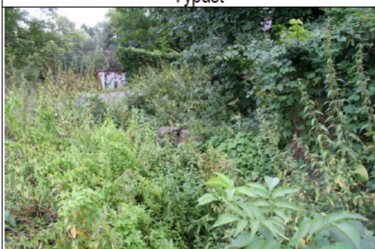
Náhon z obtokového kanálu je zanesený
