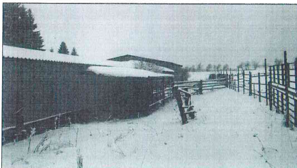
Foto č. 3 Otevřená ocelová hala na pozemku St. 1 a Ocelový přístřešek 2 + Ocelové ploty na pozemku parc. č. 152/2
