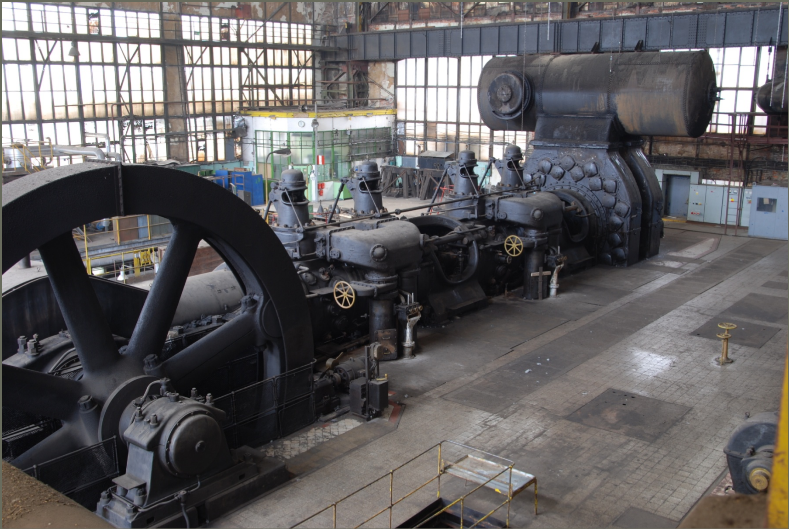
Vítkovice, energetická ústředna č. VI., pístové motory pohánějící dmychadla, 40. léta 19. století
